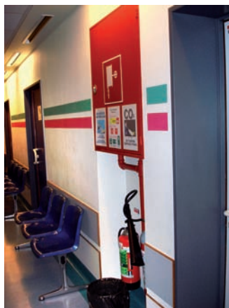
✓ Extincteur placé dans une niche
