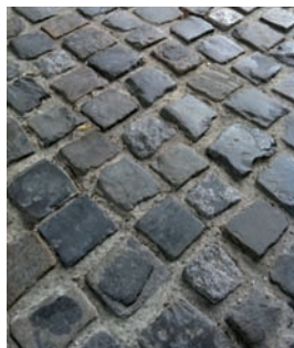
✗ Pavés bombés avec joints creux
