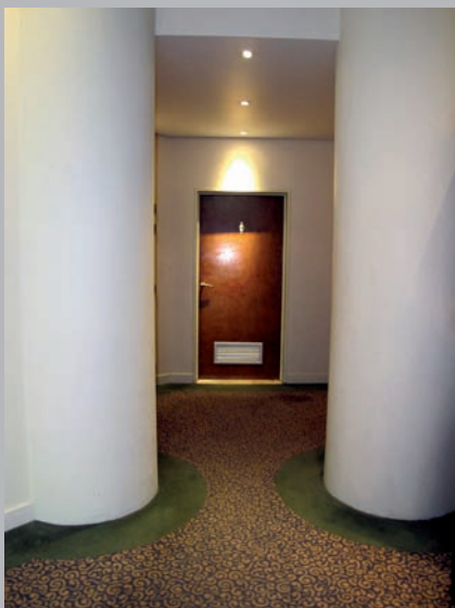
✓ Réduction ponctuelle du couloir de largeur suffisante
