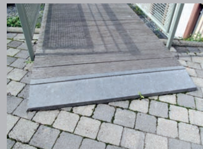
✗ Ressaut au départ de la voie d'accès
